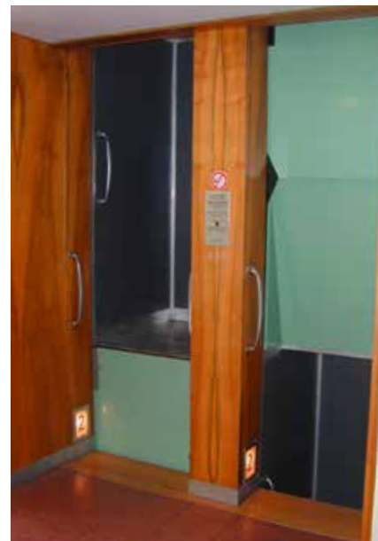
Eine besondere Rarität und damit ein beeindruckender Blickfang stellt der in der Eingangshalle des Finanzamts Augsburg-Stadt befindliche Paternoster dar.
